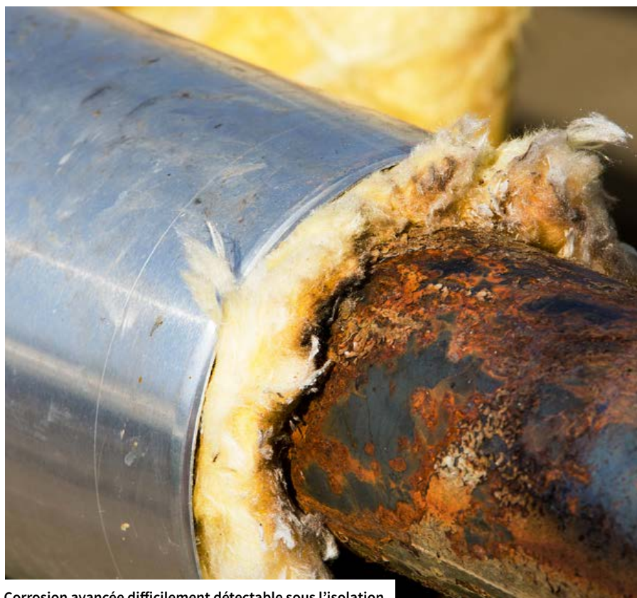
Corrosion avancée difficilement détectable sous l'isolation
