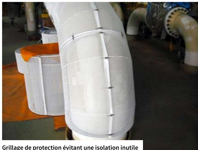
Grillage de protection évitant une isolation inutile
