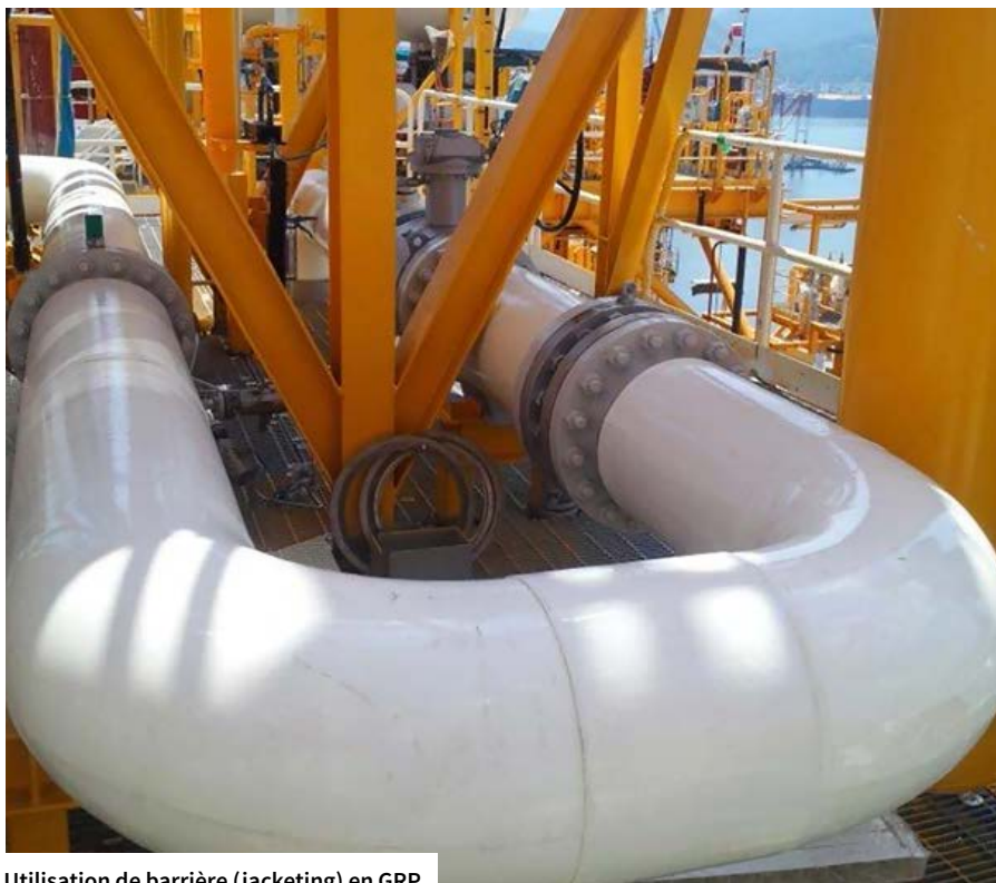
Utilisation de barrière (jacketing) en GRP
